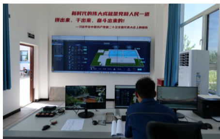
榆横矿区疏干水 中控机房
